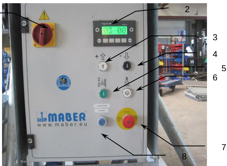
Figuur 21 – Bedieningskast op de grond
